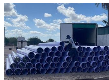
Tubería morada para el reuso de agua tratada
